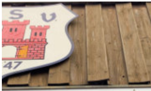
Loose Bretter - Außenfassade
