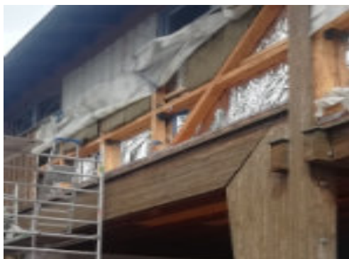
Alte Wärmedämmung TSV-Vereinsheim
